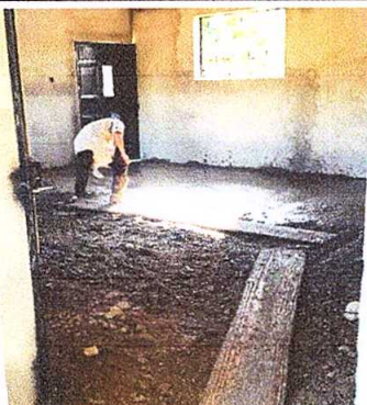
Foto7: Sustrucción de piso de concreto o granito.
