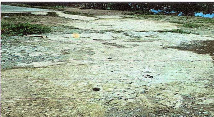
Foto 4 Piso deteriorado necesita ser sustituido
