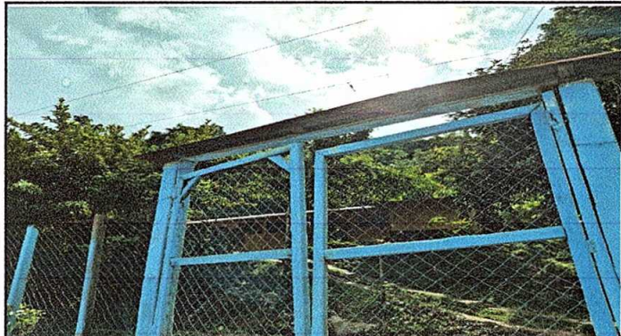
Foto1: Portón en malas condiciones
