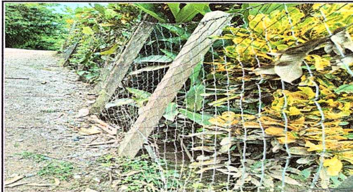
Foto 2: malla de circulación en malas condiciones
