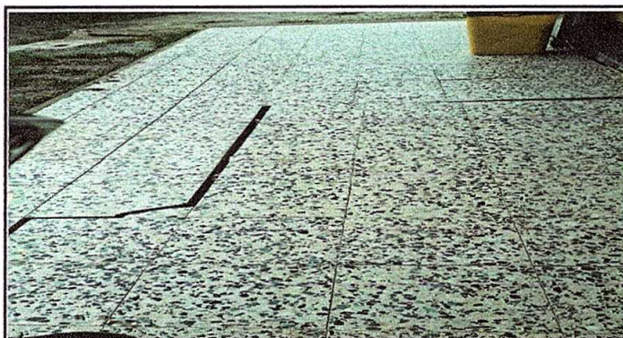
Foto 3: Piso Granito en malas condiciones
