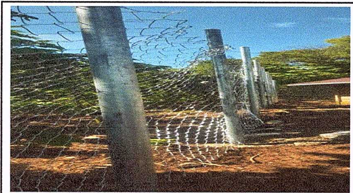
Foto 3: Sustitución de circulación de madera por tubo hg y malla galvanizada
