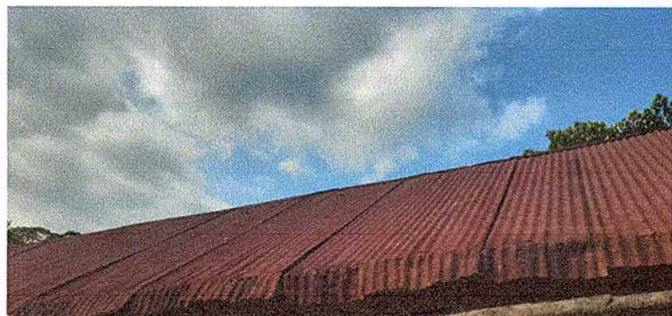
Foto1: Lámina en malas condiciones
