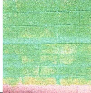
Foto 4: pintura en malas condiciones
