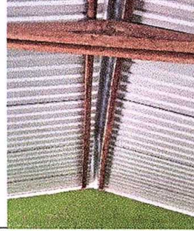
Foto 2: estructura de techos en malas condiciones
