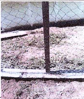
Foto 5: muro perimetral en condiciones precarias
