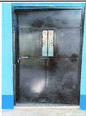
Foto 3: PUERTA DE METAL EXISTENTE DETERIORADA
