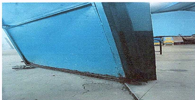
Foto 3: PUERTA DE METAL EXISTENTE DETERIORADA
