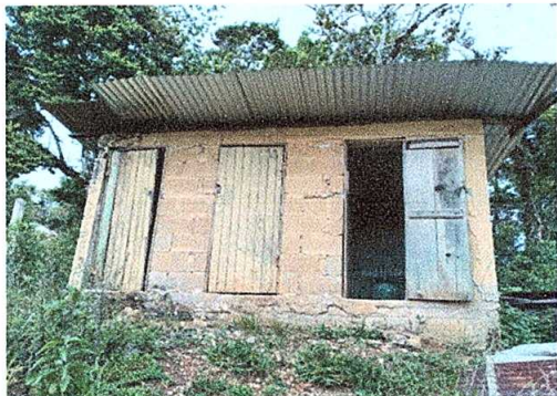
Foto 1: puerta de baño
