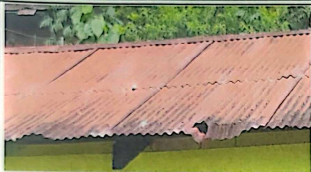
Foto1: Láminas en malas condiciones.
