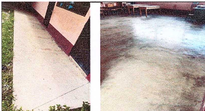
Foto 4: Sustrucción de piso de granito del patio y de aulas
