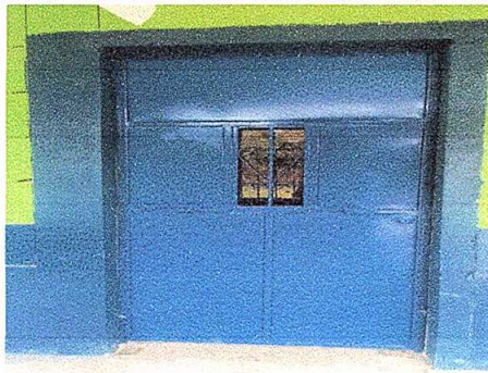
Foto 3: PUERTAS DE METAL
