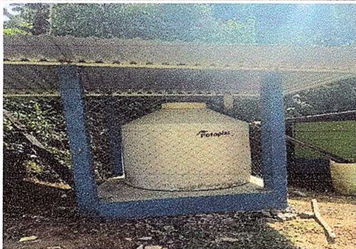
Foto 7: SERVICIOS SANITARIOS Y SUS ACCESORIOS
