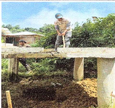
Foto 7: SERVICIOS SANITARIOS Y SUS ACCESORIOS
