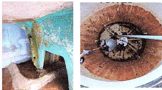
Foto 2: pila destruida y depósito de almacenamiento de agua en malas condiciones
