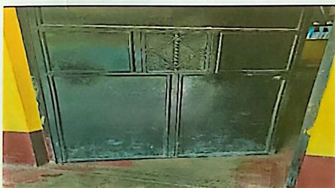
Foto 5: Sustrucción de estructura de puerta
