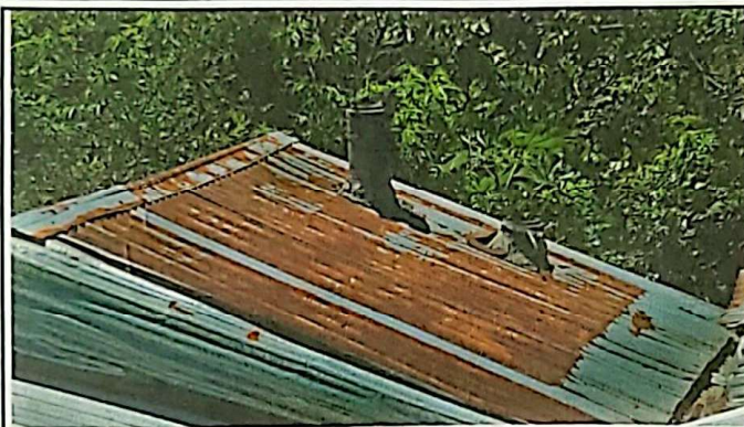
Foto 1: Sustrucción de láminas por láminas Troqueladas
