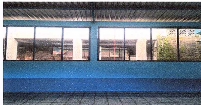
Foto 4: ventana en mal estado
