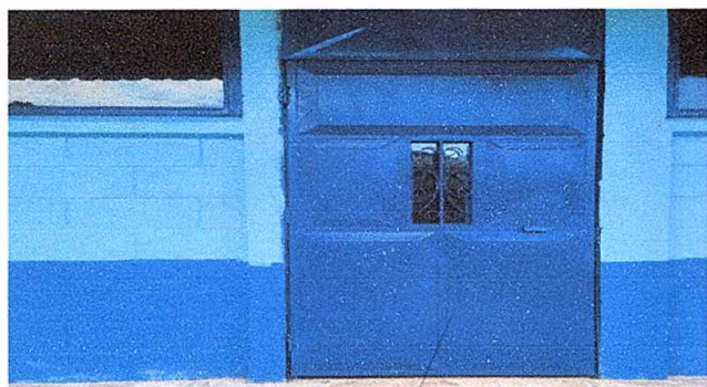
Foto 3: Puerta en mal estado
