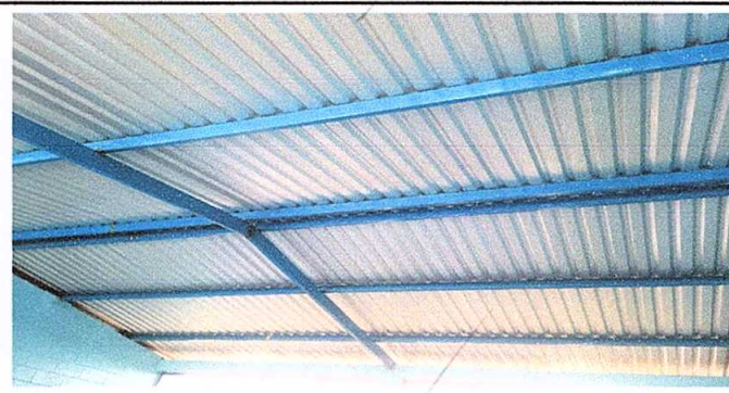
Foto 2: estructura de metal en malas condiciones
