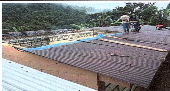
Foto 1: Lámina en malas condiciones
