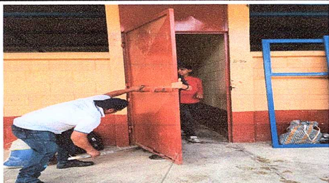
Foto 3: Puertas en mal estado
