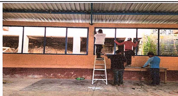
Foto 4: ventanas en mal estado
