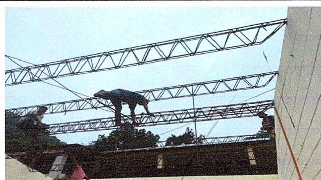
Foto 2: estructura de metal en malas condiciones
