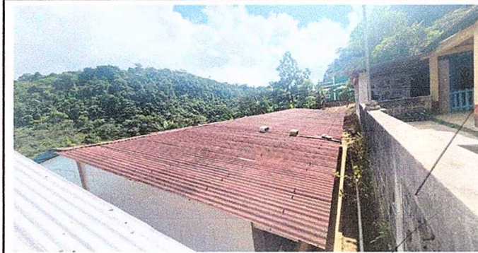
Foto1: Lámina en malas condiciones
