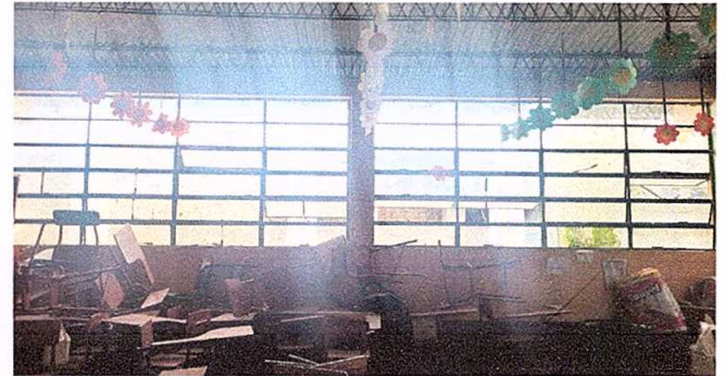
Foto 4: ventana en mal estado
