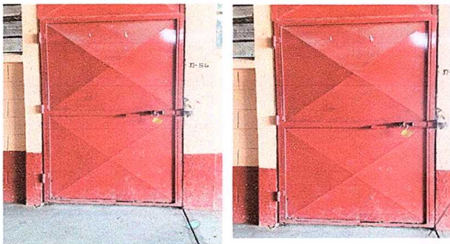
Foto 3: Puerta en mal estado
