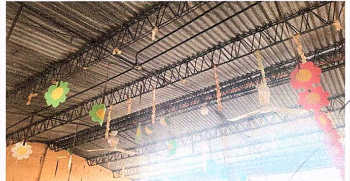
Foto 2: estructura de metal en malas condiciones
