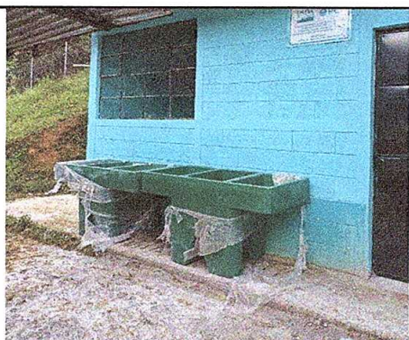
Foto 3: Pilas plásticas de 2 lavaderos
