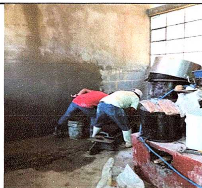
Foto 4: Repello en paredes
