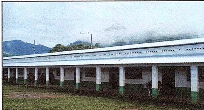
Foto 2: Aulas con goteras
