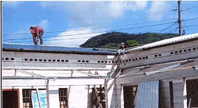
Foto 4: Capotes del entechado en mal estado
