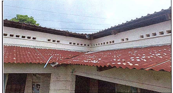
Foto 4: Capotes del entechados en mal estado.
