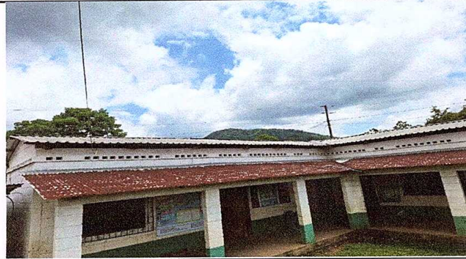
Foto1: Laminas del entechado del corredor en mal estado.
