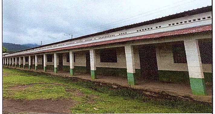
Foto 2: Aulas con goteras.
