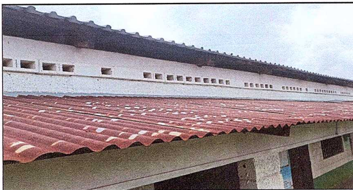
Foto 5: Reglas y bigas del entechado estan deteriorados.
