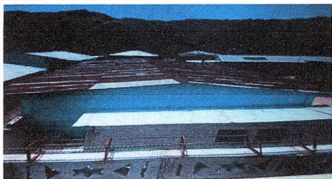
Foto1: Lamina en malas condiciones
