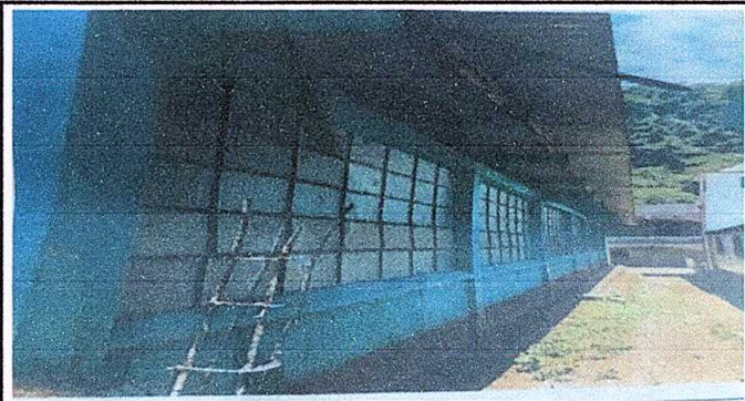
Foto 4: Canal en mal estado
