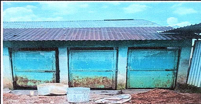
Foto 6: Sanitario en mal estado
