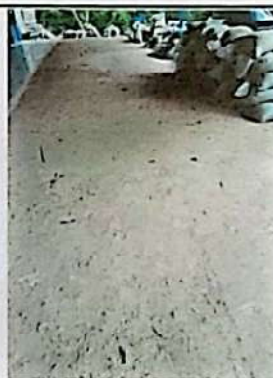
Foto 3.2: Sustrucción de piso de torta de concreto
