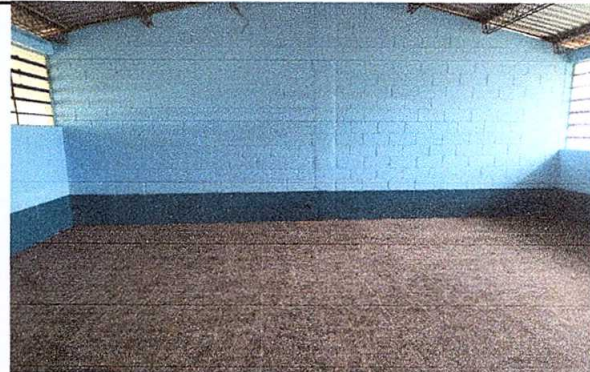
Foto 2: Piso de cemento en malas condiciones.
