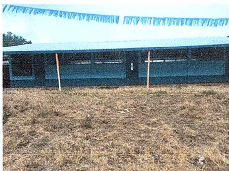
Foto 3: Pintura en mal estado en paredes. (frente)
