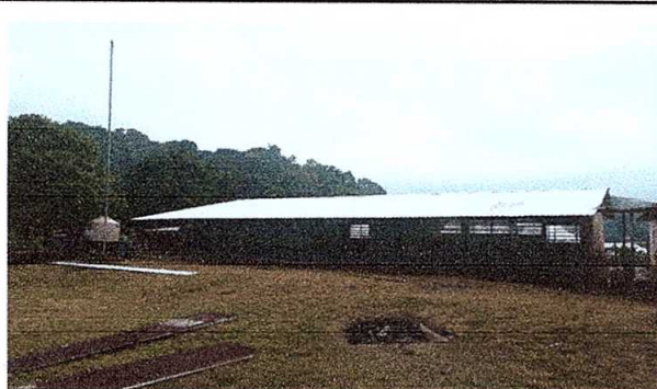
Foto1: Lámina en malas condiciones.
