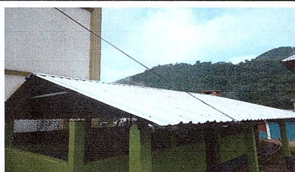
Foto 6: Lámina de la cocina en malas condiciones.
