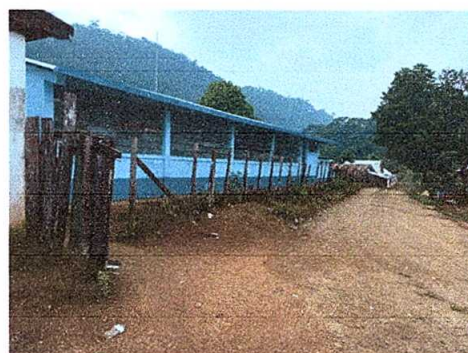
Foto 4: Pintura en mal estado en paredes. (atrás)
