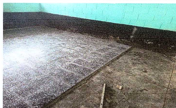
Foto 2: Piso de cemento en malas condiciones.
