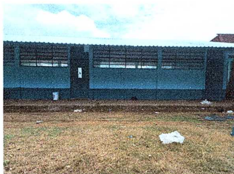
Foto 3: Pintura en mal estado en paredes. (frente)
