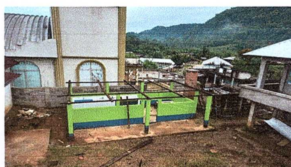
Foto 6: Láminas de la cocina en malas condiciones.
