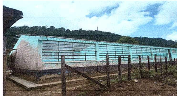
Foto 4: Pintura en mal estado. (atrás)
