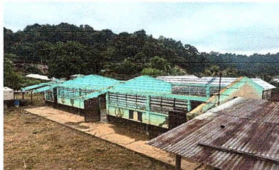
Foto 1: Lámina en malas condiciones.
