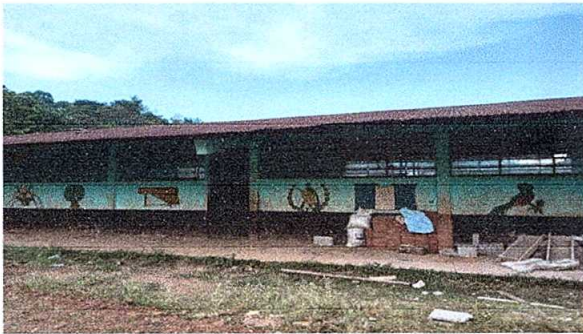
Foto 3: Pintura en mal estado en paredes (frente)
