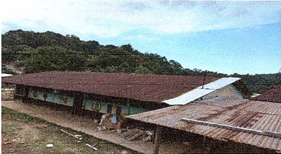
Foto1: Lámina en malas condiciones
