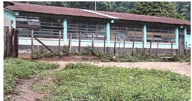
Foto 4: Pintura en mal estado en paredes (atrás)
