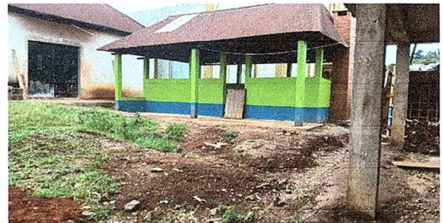
Foto 6: Lámina de la cocina en malas condiciones
