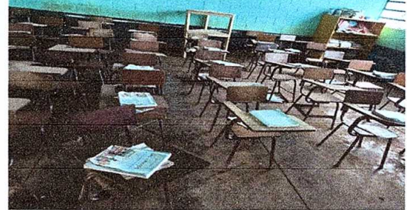
Foto 2: Piso de cemento en malas condiciones
