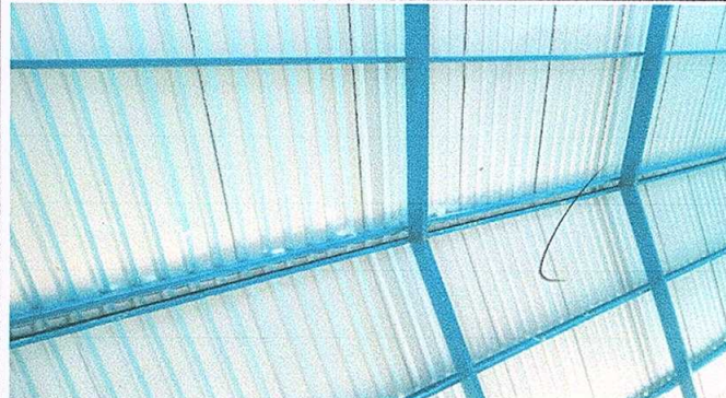
Foto 2: Estructura de soporte de madera, por metal en malas condiciones
