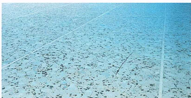
Foto 3: Piso en mal estado
