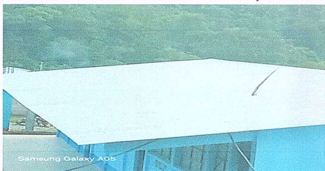
Foto1: Lámina en malas condiciones
