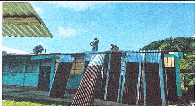
Foto 1: Lámina en malas condiciones
