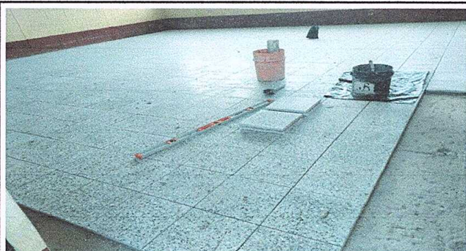
Foto 3: piso en mal estado
