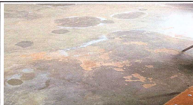
Foto 3: piso en mal estado
