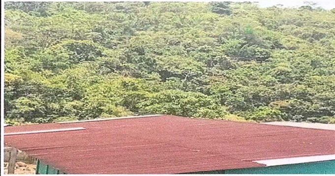
Foto 1: Lámina en malas condiciones
