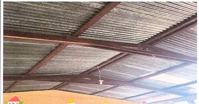
Foto 2: estructura de soporte de madera, por metal en malas condiciones
