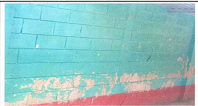
Foto 4: pintura en mal estado
