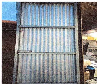
Foto 4: Puerta en mal estado
