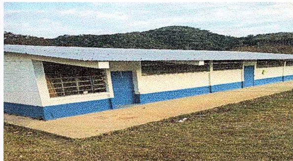
Foto 2: Ventanas en mal estado
