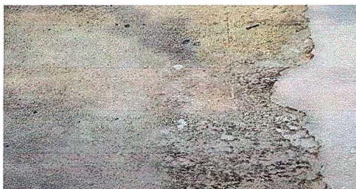
Foto 3: Piso en mal estado
