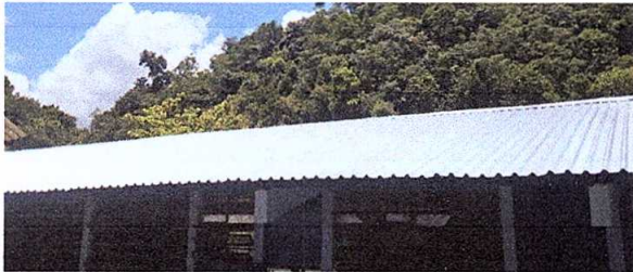
Foto 1: Lámina en malas condiciones.
