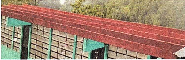
Foto 1: Lámina en malas condiciones.
