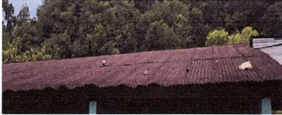
Foto 1: Lámina en malas condiciones.
