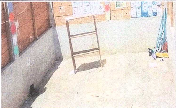
Foto 1: Sustrucción de piso de granito
