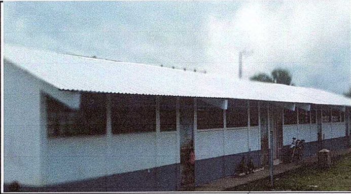
Foto1: Laminas en malas condiciones.
