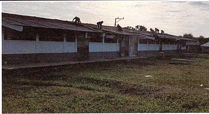
Foto1: Laminas en malas condiciones.
