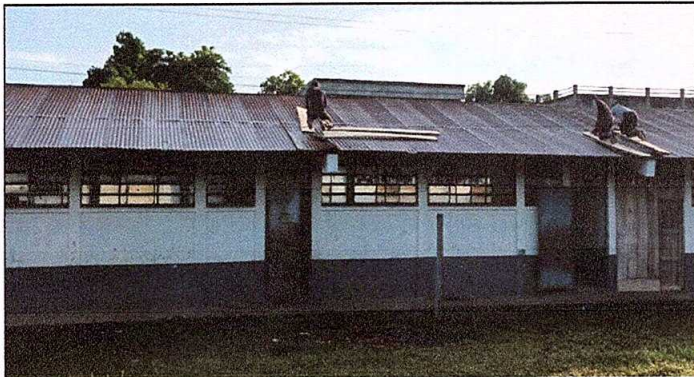
Foto 3: Goteras en laminas de techos.
