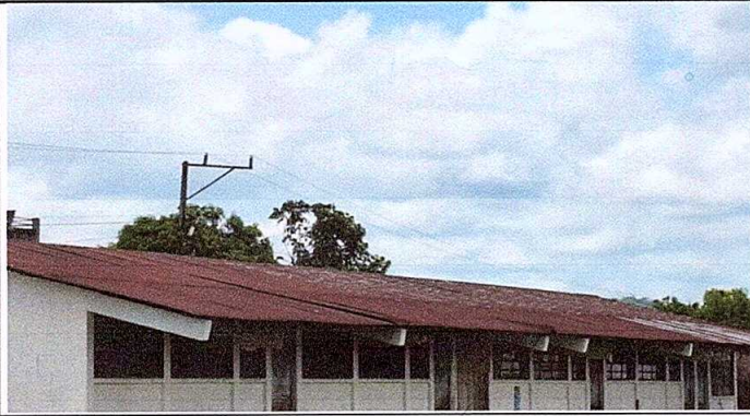
Foto 1: Láminas en malas condiciones
