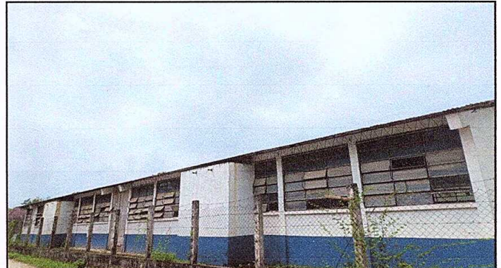
Foto 4: Necesidad de colocacion de costaneras.
