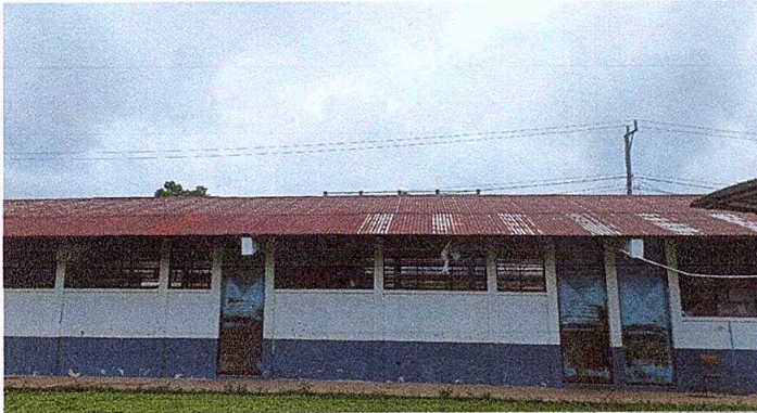
Foto 3: Goteras en laminas de techos.
