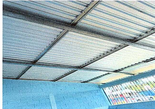
Foto 2: Estructura de techo en malas condiciones
