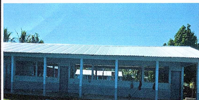
Foto 1: Lámina en malas condiciones
