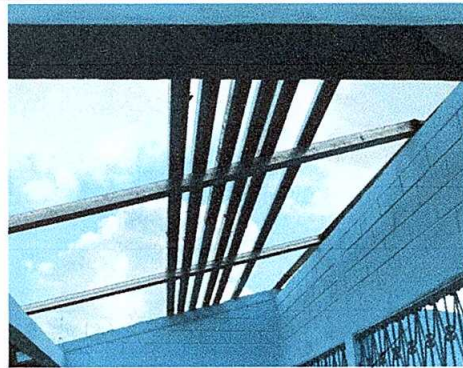
Foto 2: Estructura de techo en malas condiciones
