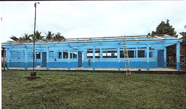
Foto 1: Lámina en malas condiciones
