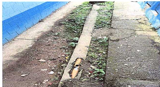
Foto 6: Torta de concreto en malas condiciones
