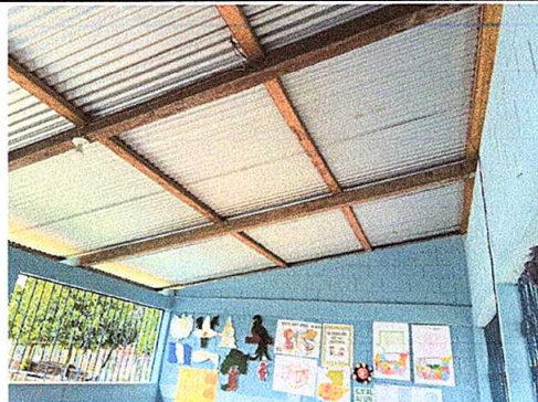
Foto 2: Estructura de techo en malas condiciones
