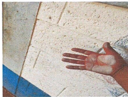
Foto 2: Pintura en mal estado y de baja calidad.
