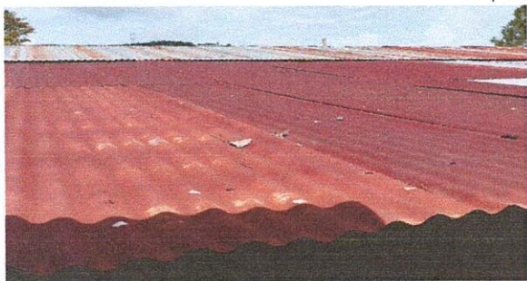
Foto 3: Techo en mal estado, muy oxidado.
