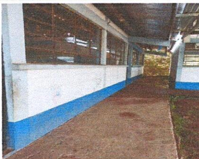
Foto1: Vidrios de ventanales propensos a ser quebrados, colocar balcones.
