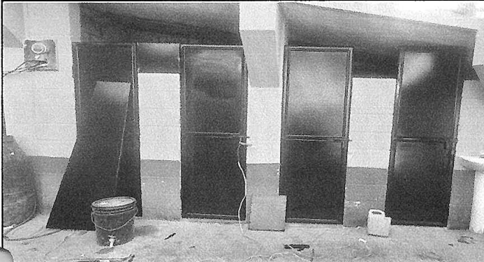
Foto 1: Sustrucción de puerta en servicios sanitarios
