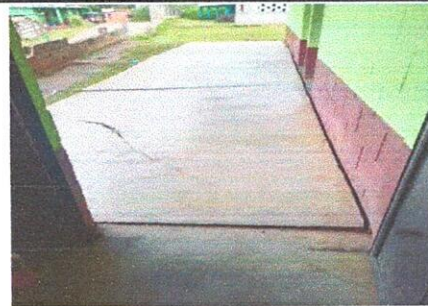
Foto 6: Sustrución de piso de torta de concreto
