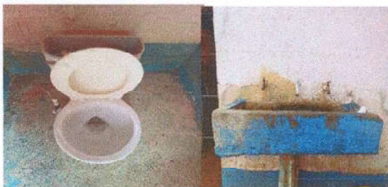
foto 5 SERVICIOS SANITARIOS Y SUS ACCESORIOS
