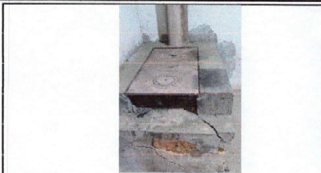
Foto 7: SUSTITUCIÓN DE PLANCHETA DE ESTUFA RURAL
