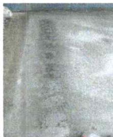
Foto 3: Sustrucción de piso de torta de concreto
