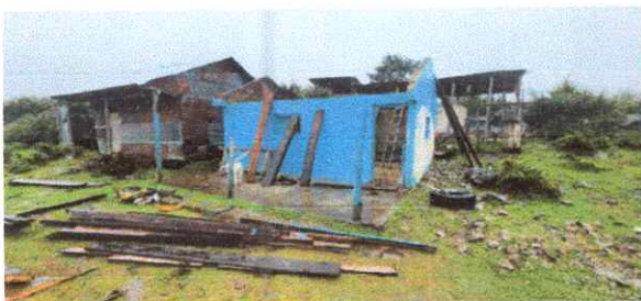
Foto 3: Techo de lamina de zinc de la cocina con bastante daño, necesitando su reemplazo total.
