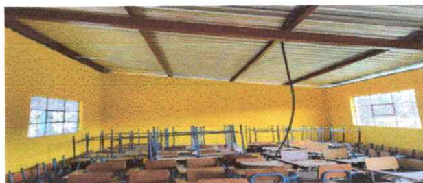
Foto 6: Interior de aulas con daño en sus paredes necesitando mejora estetico con pintado de sus muros.
