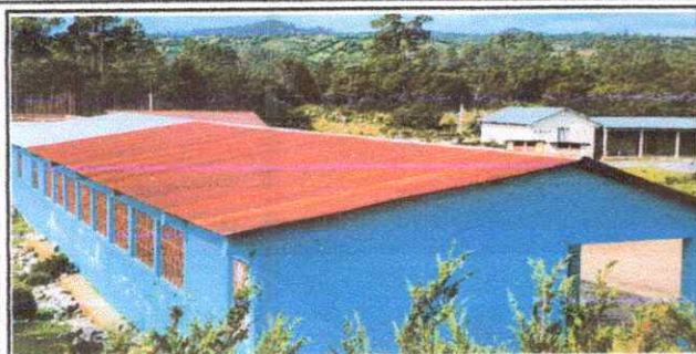
Foto 7: Cuatro alas , bodega y direccion con techo en mal estado, estado desde su construccion no se ha reemplazado, por lo que se necesita sustitucion de techo lamina zin a troquelada calibre 26.
