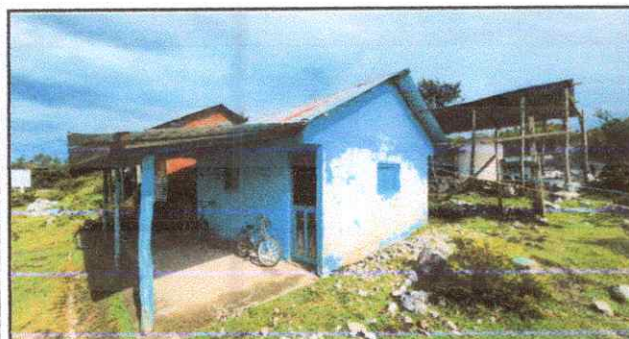
Foto 9: Techo de lamina de zinc de la cocina con bastante daño, necesitando su reemplazo total asi como su estructura de madera a metal y pintado de sus muros. Area de la cocina escolar.
