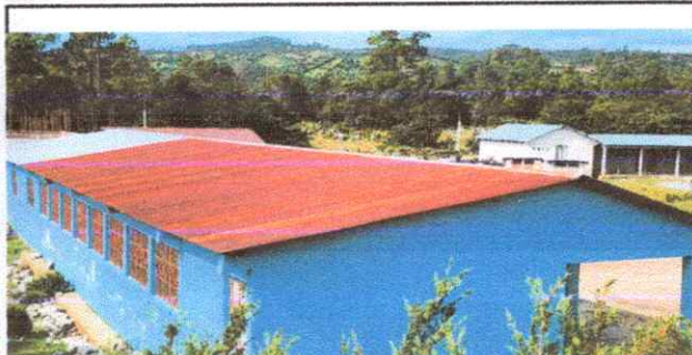
Foto 8: Techo necesita sustitucion de capote y tornillos de fijacion de lamina, debido al deterioro que presentan.
