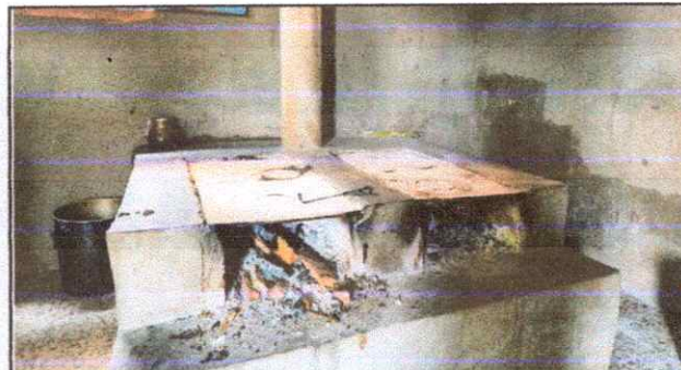
Foto 10: Plancha para cocinar en mal estado , se necesita mejorar y sustituir ambas planchas de metal y su remodelacion.
