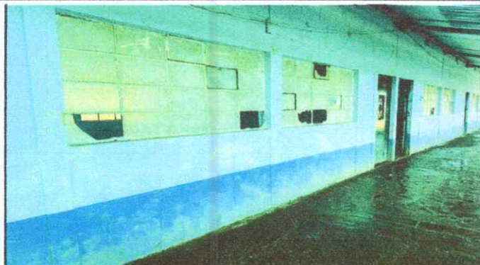
FOTO 7: SE NECESITA INSTALACIÓN DE BALCONES DE METAL, APLICACIÓN DE PINTURA DE EXTERIOR
