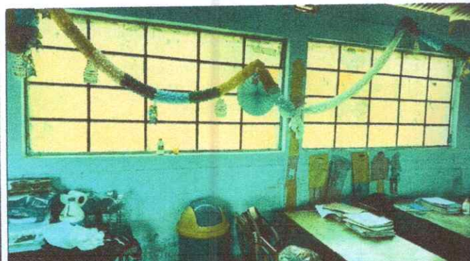
FOTO 19: REPELLO EN MURO INTERIOR DE AULA
