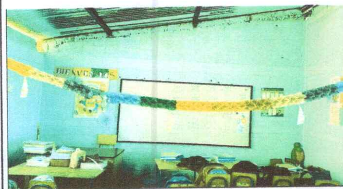
FOTO 21: REPELLO EN MURO INTERIOR DE AULA
